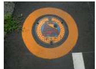
消火栓近景(丸型)
