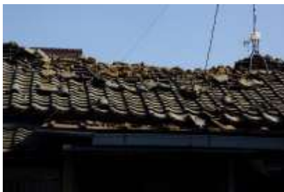
写真 保存地区における震災被害の様子
