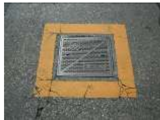
消火栓近景(四角型)
