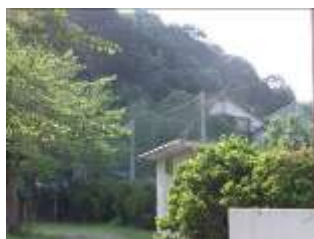
急傾斜地崩壊危険箇所
