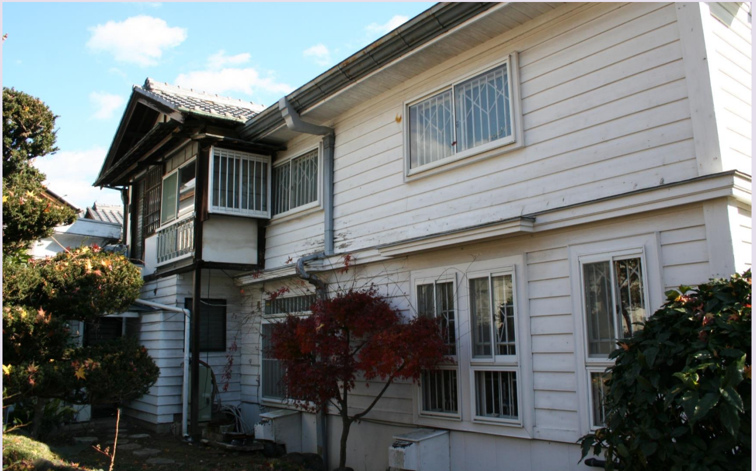
サロン北西側 建具の外側に後補のアルミサッシが取り付けられている。
