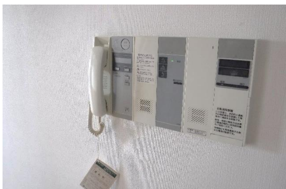
緊急通報装置（相生町5丁目団地）
