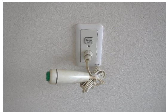
緊急呼び出しボタン（相生町5丁目団地）
