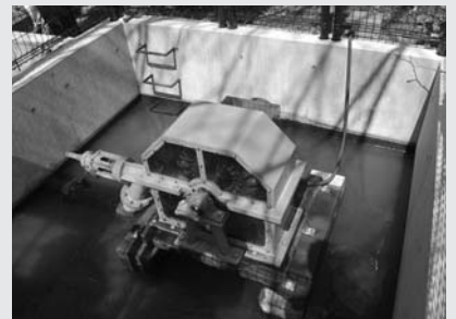
(小水力発電設備)
