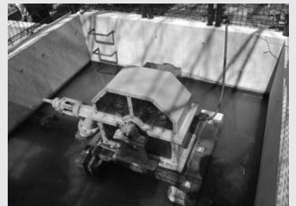
(小水力発電設備)
