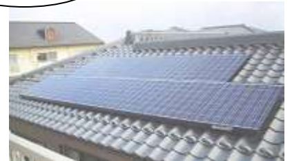
太陽光発電パネルの設置例
