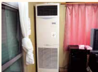
第16区自治会 エアコン
