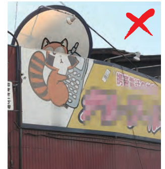
破損して危ない看板（群馬県）
