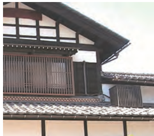
窓の格子に合わせて室外機を目隠し (越前市)
