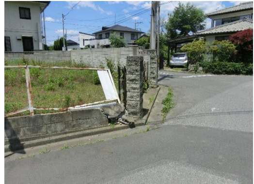
敷地角の門柱跡 一部フェンスの破損有り
