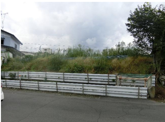
敷地の東側から撮影① 崖地のおそれ有り
