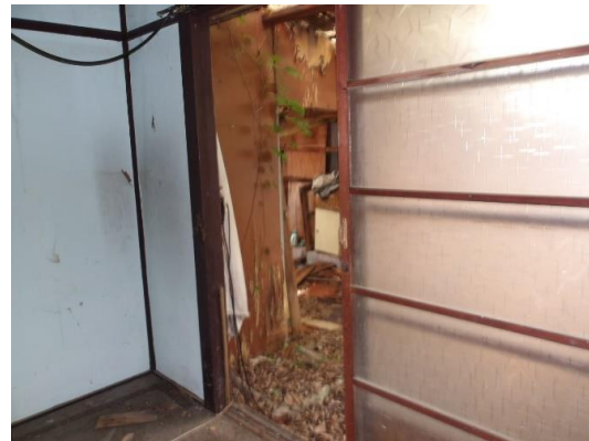
建物内部は損傷が多数あり
