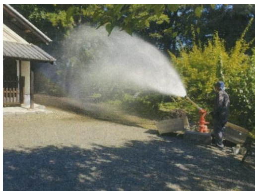
彦部家住宅 消火設備点検
