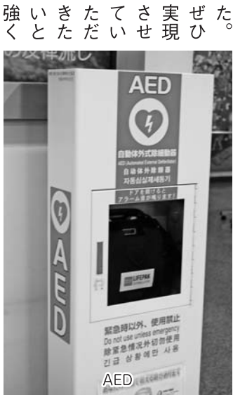
この表示のとおり、緊急時以外、使用禁止。Do not use unless emergency. 除震急時以外切当使用。긴급 상황에만 사용.
