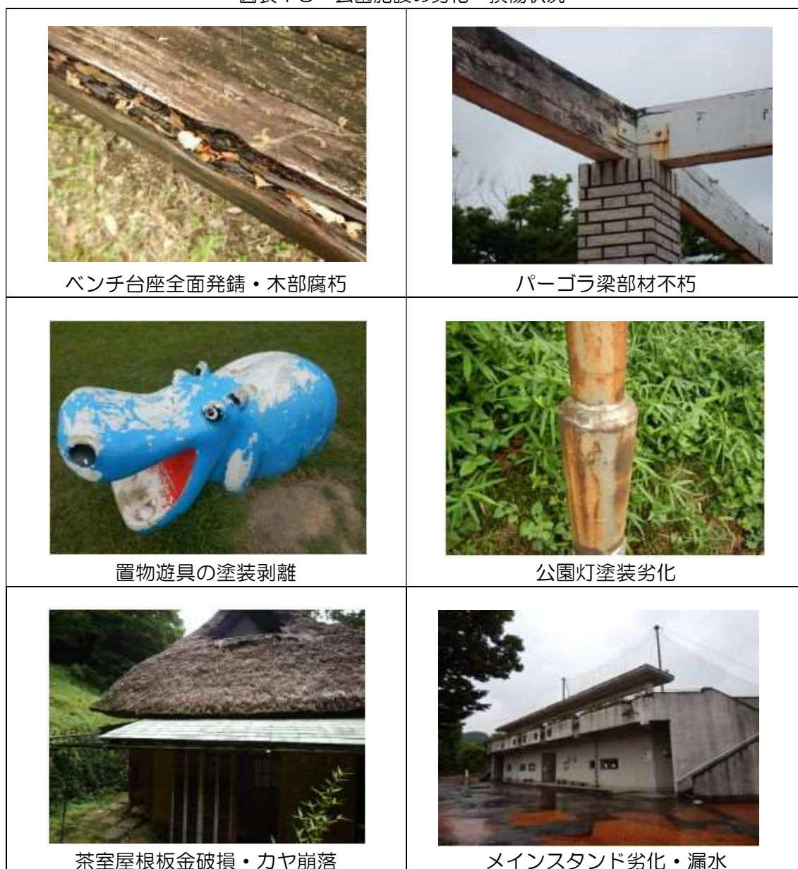
図表 1 8 公園施設の劣化・損傷状況
