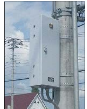
【信号機電源付加装置の整備】
