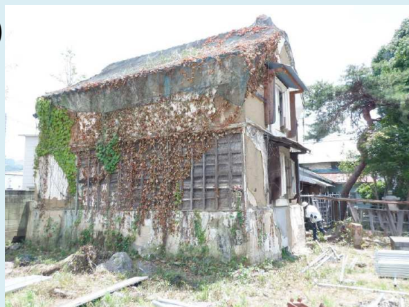
修理前の蔵の様子
