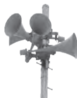
防災行政無線 （屋外スピーカー）
