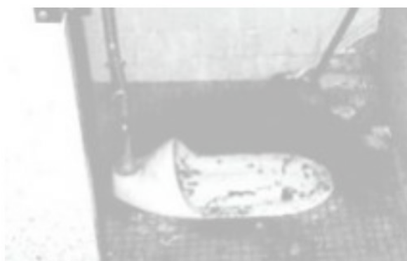
阪神・淡路大震災（1995年） し尿で詰まり、使用不能に
