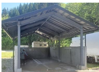
運搬車両庫内の洗浄場 ↑
