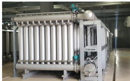
↑膜ろ過装置 (1ユニット)
