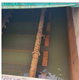
生物接触ろ過池
