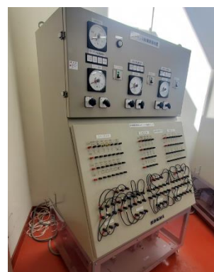
(シーケンス制御実習装置)
